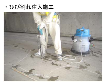
床面ひび割れ
