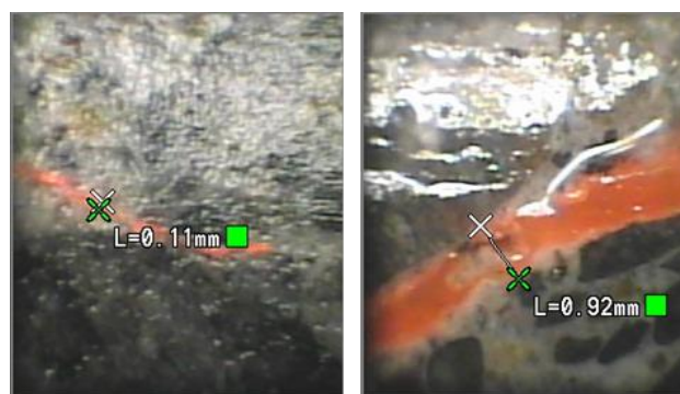
写真 11 ひび割れ幅の測定結果
