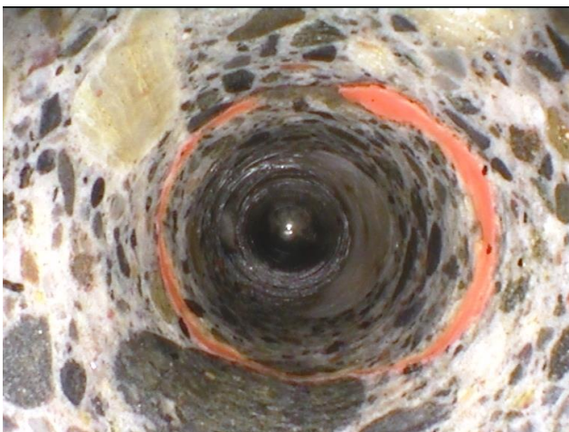
写真9 撤去床版内部に発生している水平ひび割れ
