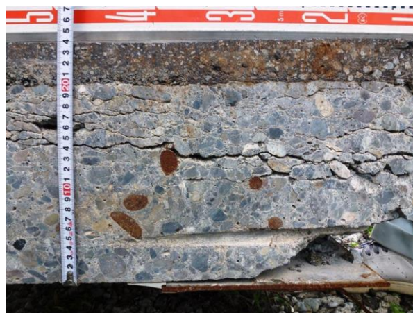
写真1 RC床版内部に発生した水平ひび割れ
