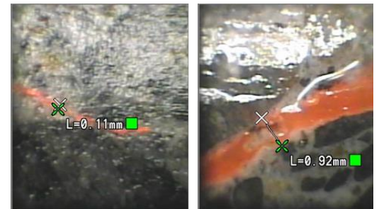
写真5 ひび割れ幅の測定結果
