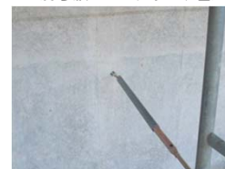
施工前 (ひび割れ幅0.15mm)
